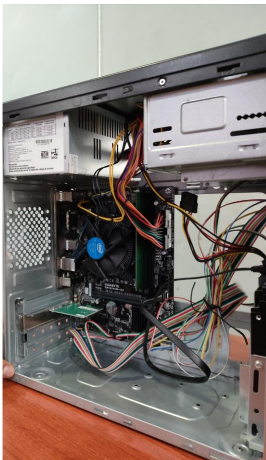
Figura 2 Mantenimiento correctivo, se presentaron piezas dañadas por un calor excesivo
